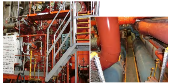
図6 左:大阪万博から移設されたボイラー。右:専用溝に敷設された開業当初からの高温水用(赤)及び冷水用(青)導管。
