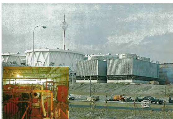
図2 大阪万博当時の地域冷房東プラント。左後ろの円形の建物は日本館。左下の挿入は建設中の機器室。（出典：[6]）
